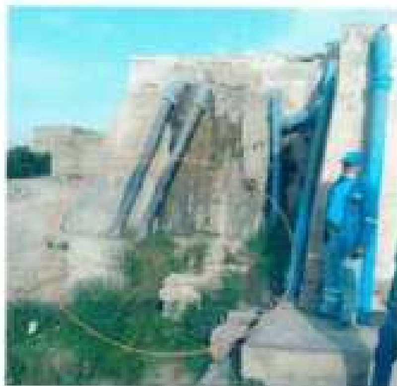
Reservorio sector atajea 170 m 3
