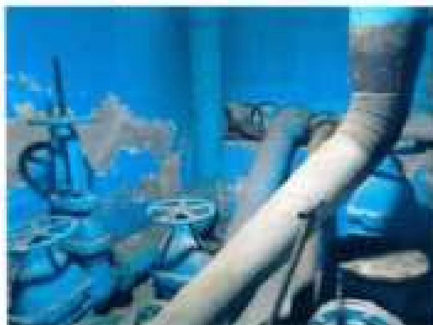
Figura 12. Tuberías en mal estado
